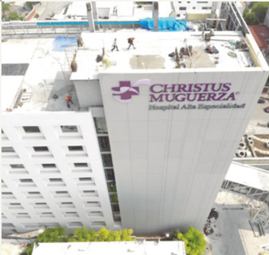
◀ Proyecto: Hospital Christus Muguerza Torre Poniente de Alta Especialidad Cliente: Christus Muguerza Ubicación: Monterrey, Nuevo León
